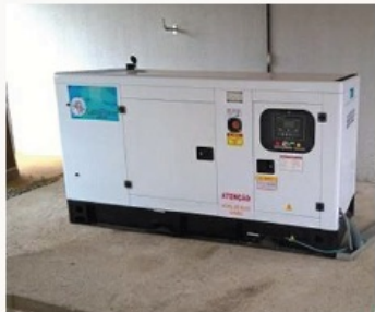
Gerador de energia elétrica do Data Center da DTI (Foto: DTI)
