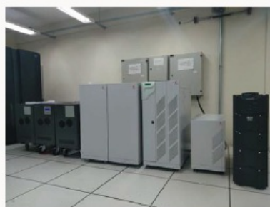
Nobreaks do Data Center em pleno funcionamento (Foto: DTI)
