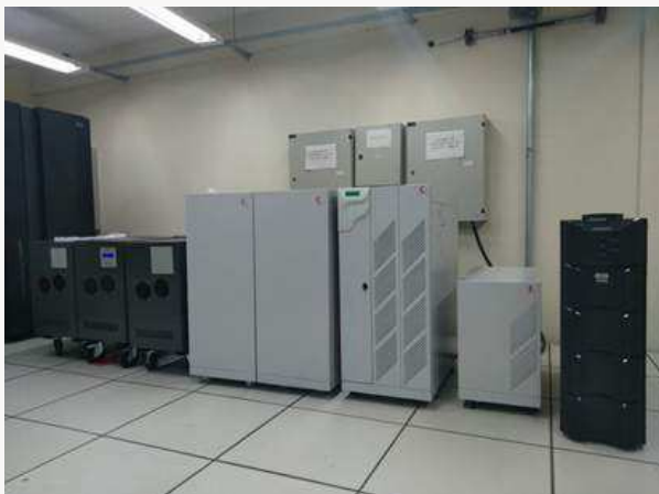
Nobreaks do Data Center em pleno funcionamento (Foto: DTI)
