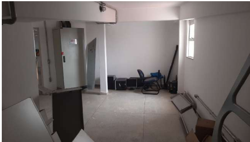
Figura 47. Sala do quadro de energia
