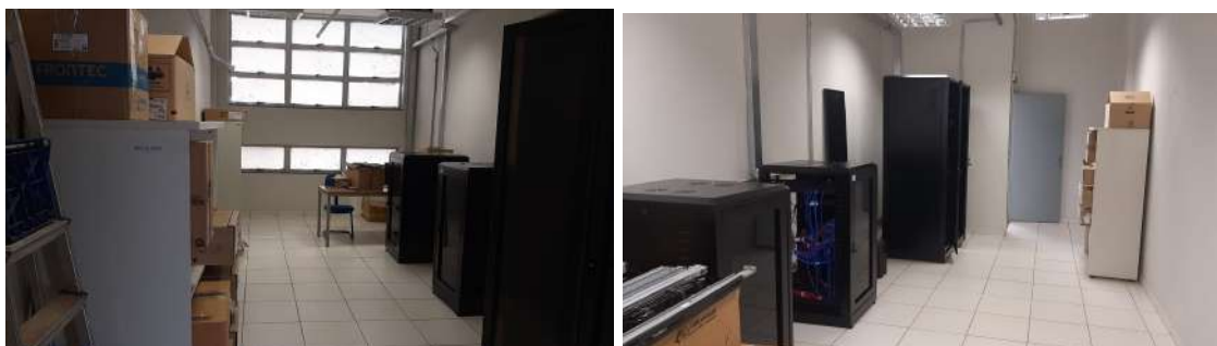
Figura 11. Sala do Data Center
