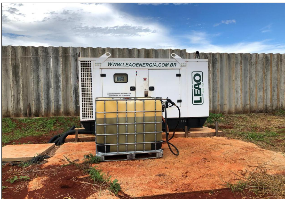
Figura 4 - Gerador a óleo diesel que mantém a energia elétrica no Campus de Unai.
