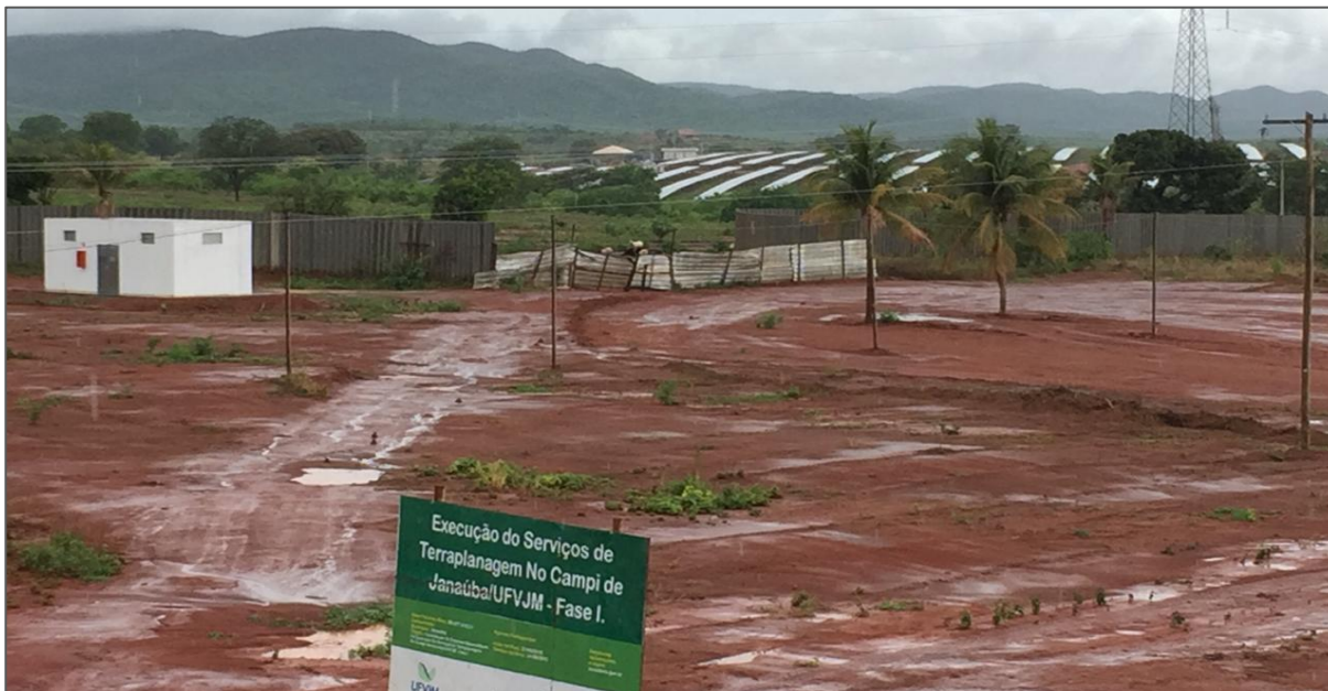
Figura 8 - Imediações do Campus de Janaúba, na qual pode ser notada a depreciação da terraplanagem. Em dias de chuva o acesso ao Campus fica comprometido.
