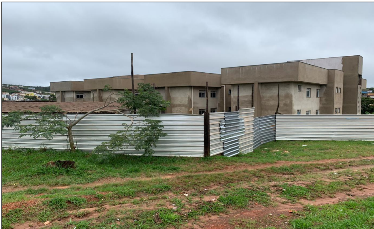
Figura 10 - Foto de um dos blocos inconclusos da Moradia Estudantil da UFVJM, na cidade de Diamantina-MG.
