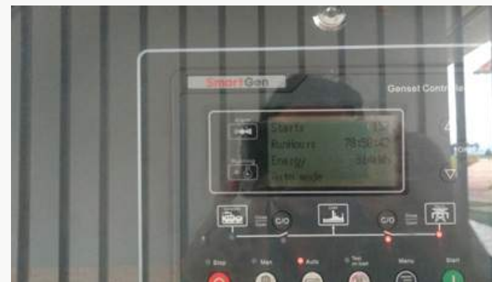
Horímetro do gerador com registro de aproximadamente 80 horas de operação (Foto: DTI)
