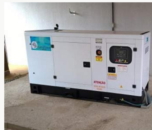
Gerador de energia elétrica do Data Center da DTI (Foto: DTI)
